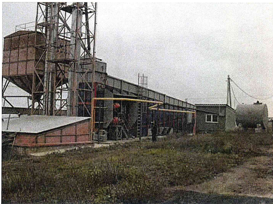
Рисунок 2. Зерносушилка конвейерного типа Motum-40 в работе в составе технологической линии.
